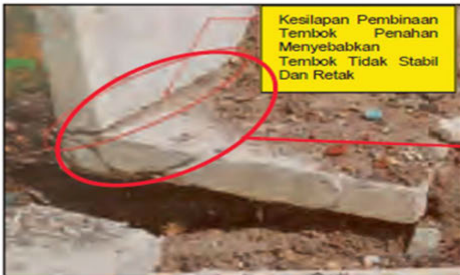
Lokasi : Tembok Belakang Bangunan Tarikh : 17 Jun 2009 Sumber : Laporan Penilaian Kerja-kerja Pembinaan
