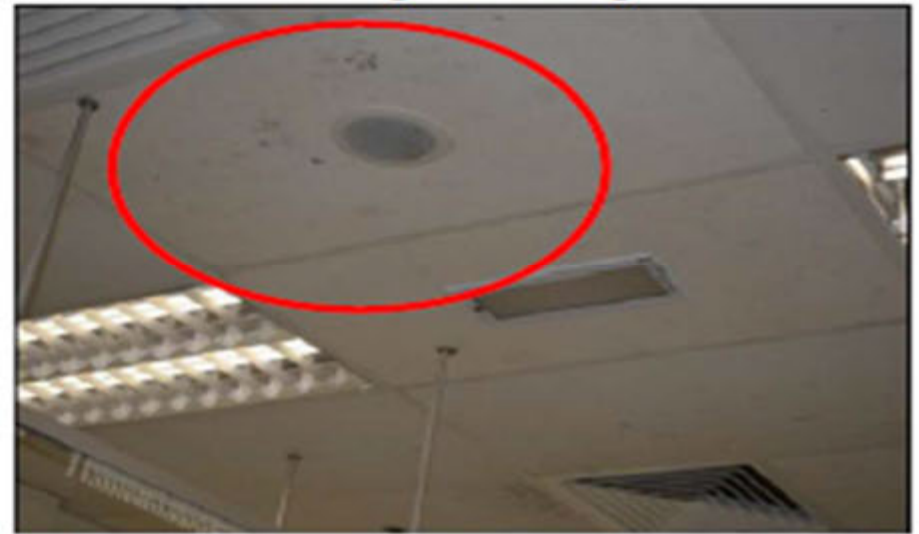
Kulat Dan Kesan Wap Air Kelihatan Pada Siling Bumbung
